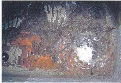
●汚れたタンク
